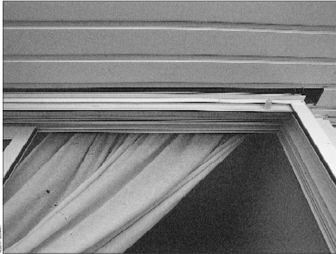
Les caixes de les persianes estan mal instal·lades i entra el fred als habitatges
