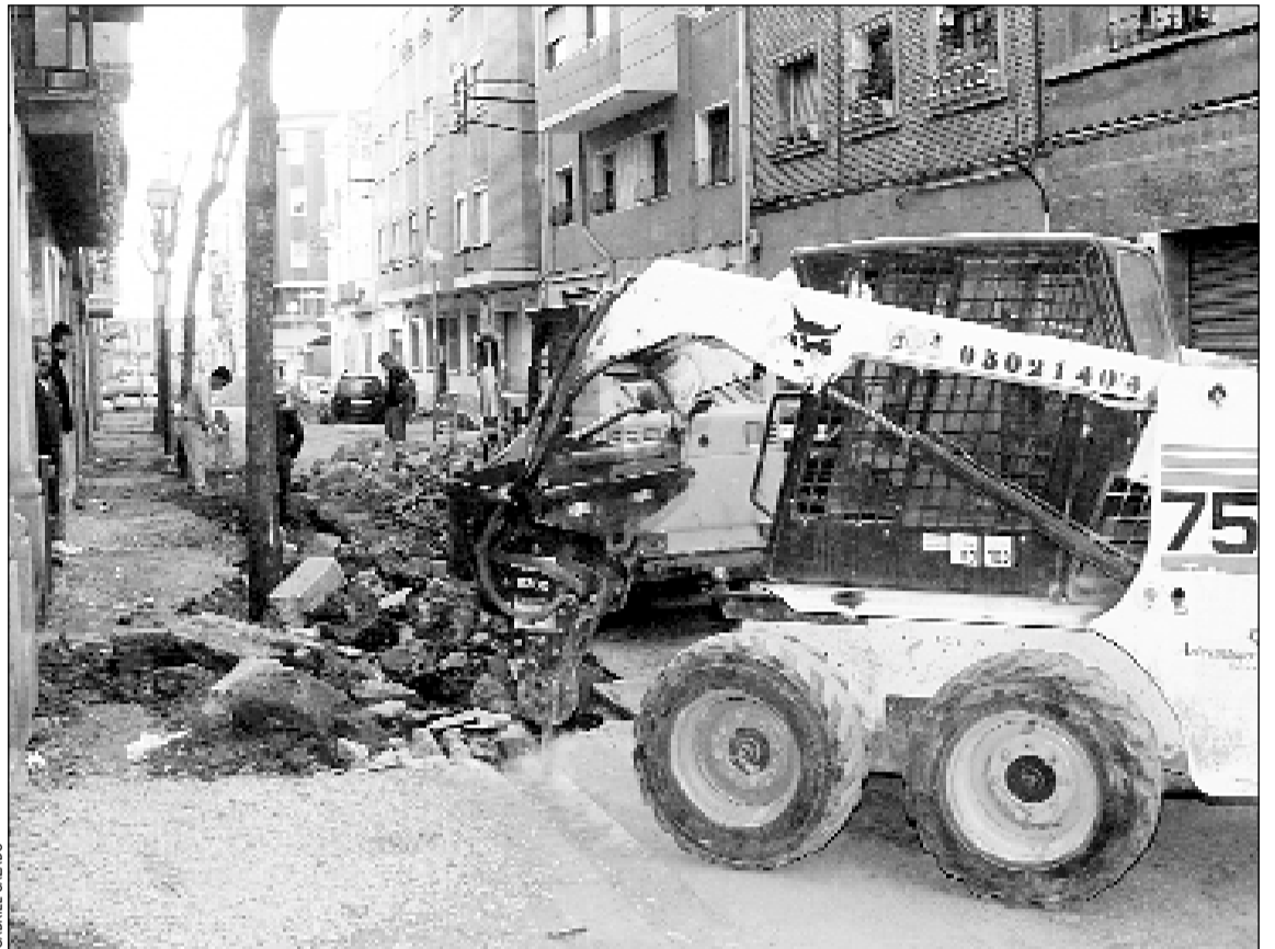
La reforma de la calle Llobregat se ha iniciado en el tramo Ronda de la Torrassa-Montseny
