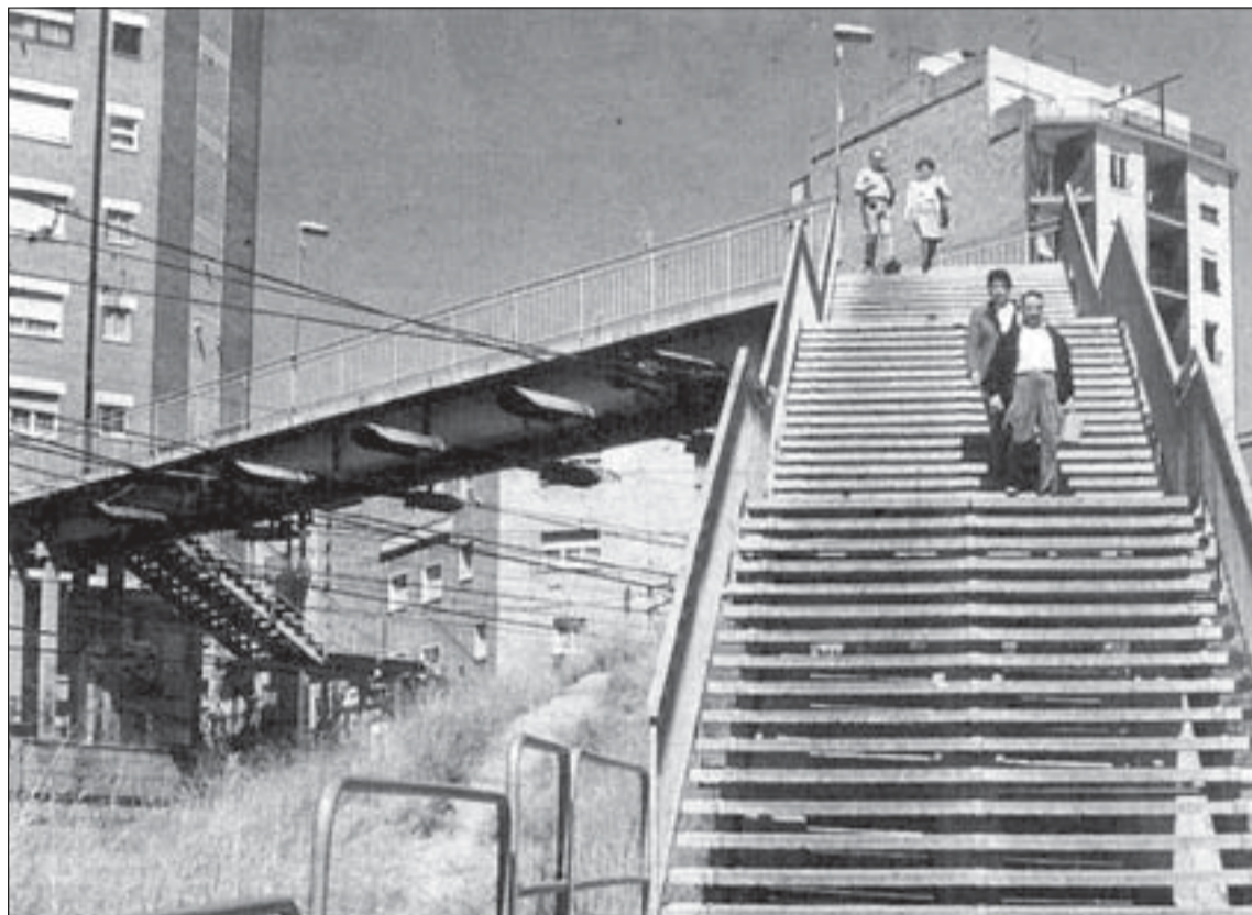
El mal estado de las escaleras del puente ha provocado las quejas de los vecinos
