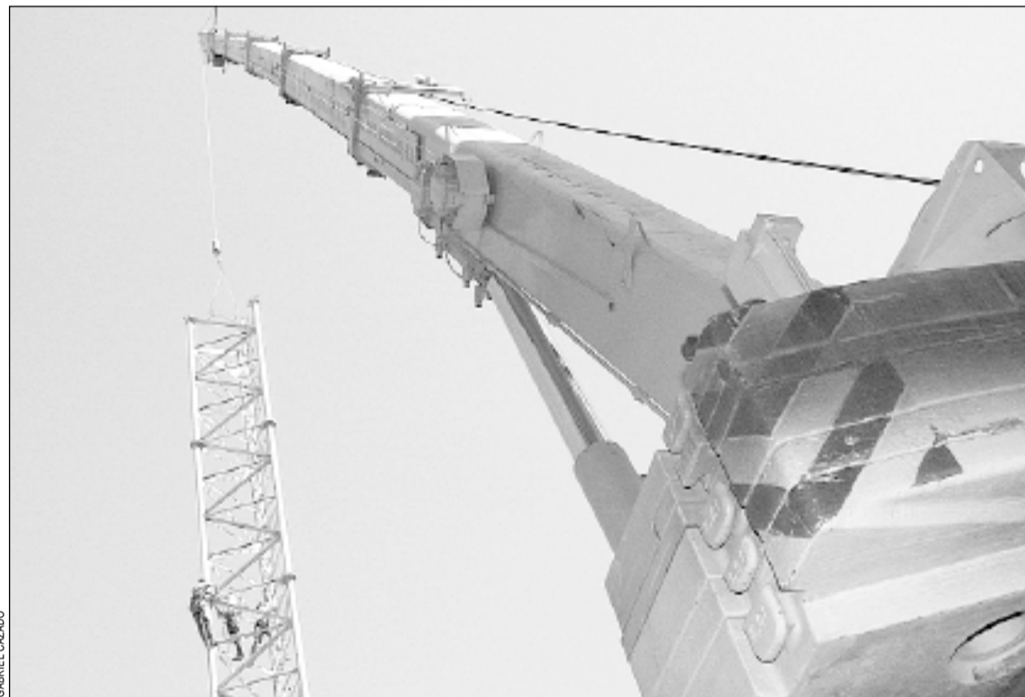
Desmantelamiento de una antena de telefonía móvil entre Isabel la Católica y la calle Almadén
