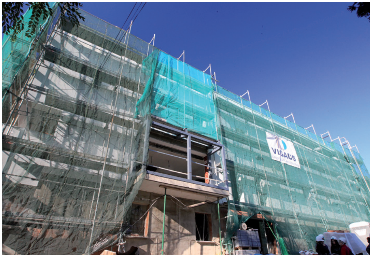
Fachada del edificio de la residencia Els Alps, ubicada en la calle Miquel Peiró, en plena reforma
