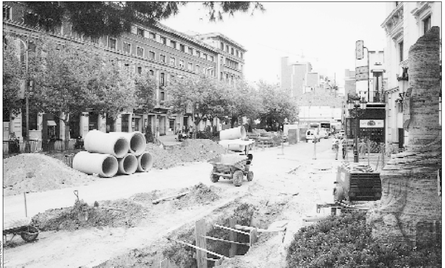
Las excavadoras han ocupado la plaza del Ayuntamiento para iniciar la construcci n del aparcamiento subterr neo
