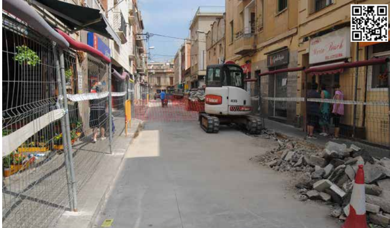
Treballs de reforma del carrer Príncep de Bergara, entre el carrer Major i l'avinguda del Carrilet
