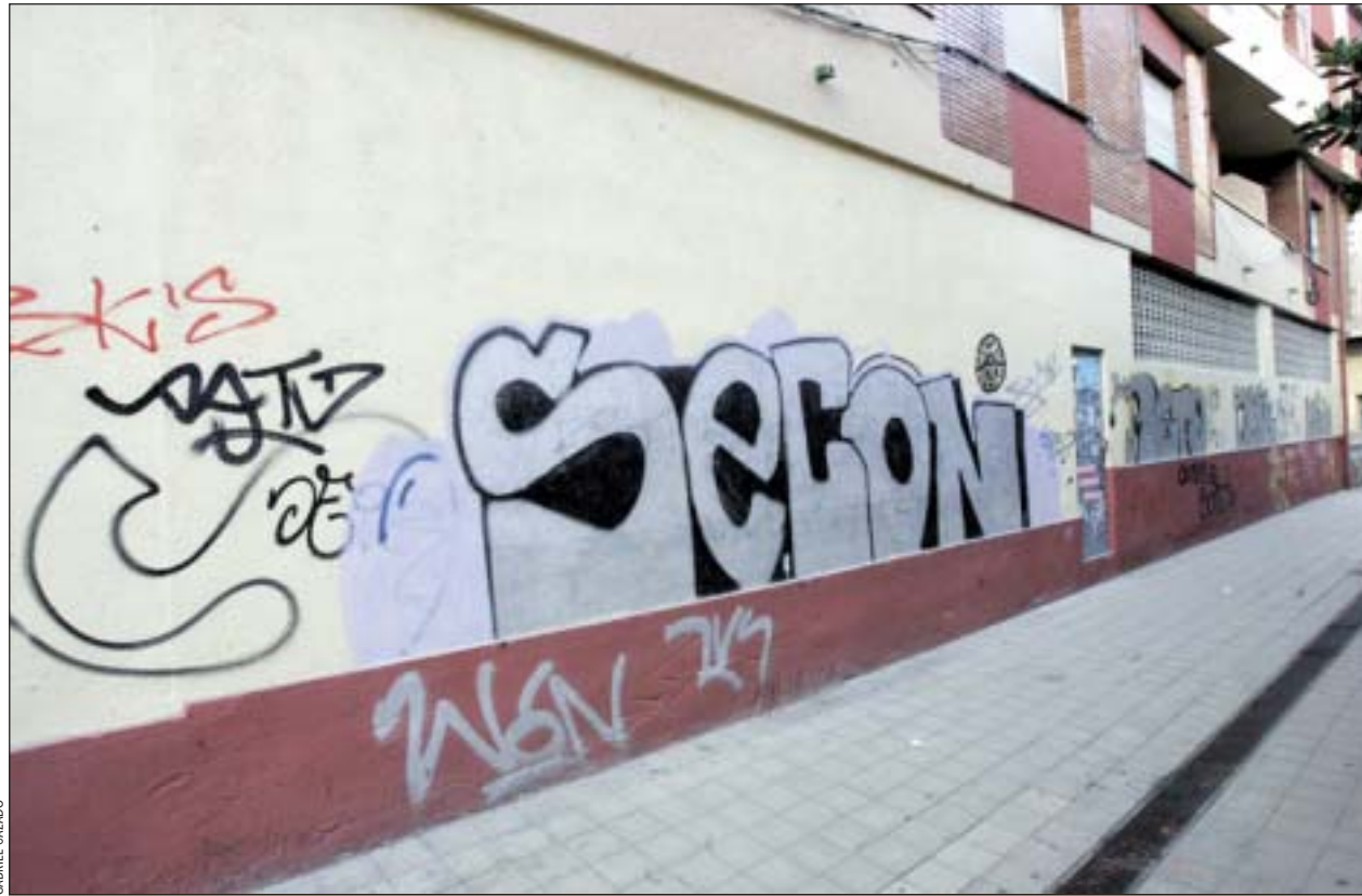
Tramo de la calle Sant Roc repleto de pintadas incontroladas en edificios privados
