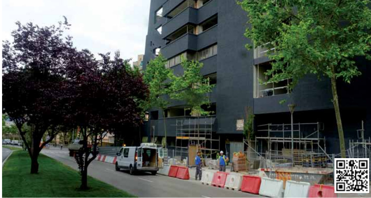
Façana en obres del futur centre de Planeta Formació i Universitats, a l'avinguda de Josep Tarradellas i Joan
