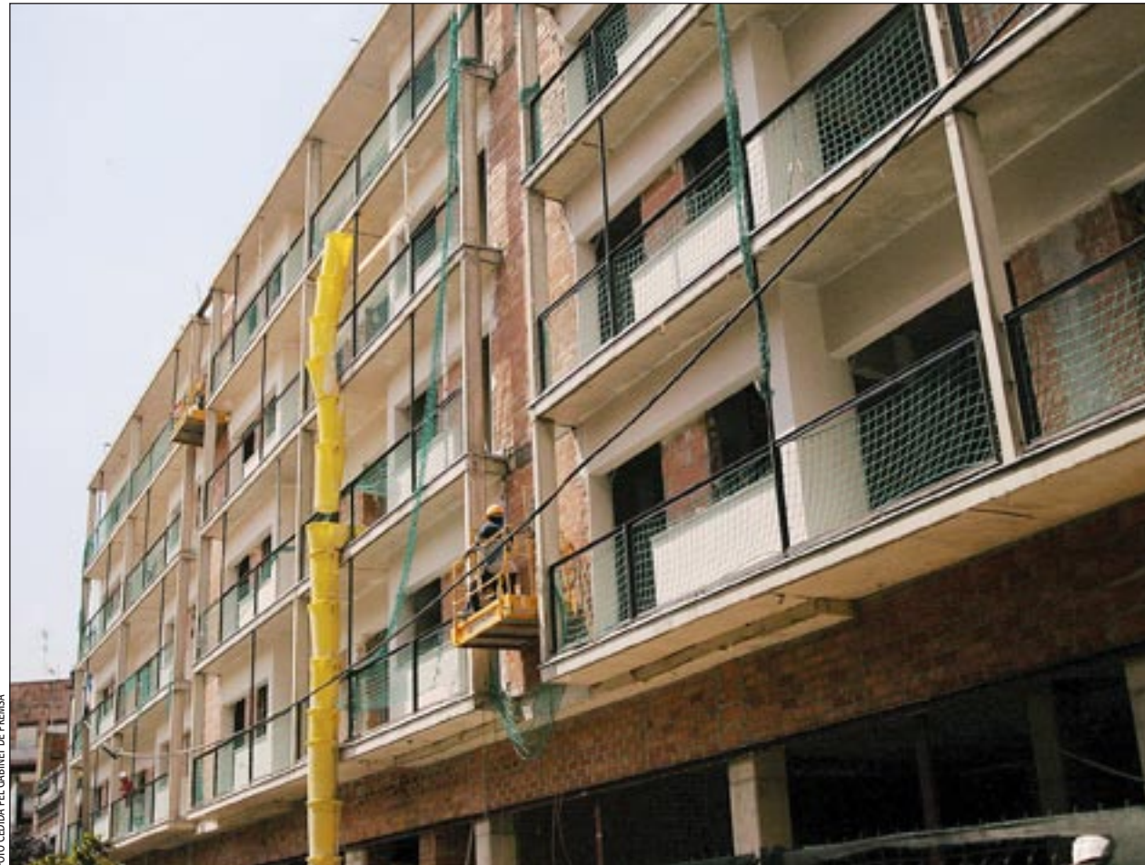
Edifici en construcció al solar que abans ocupava la fàbrica Vidrieres Llobregat
