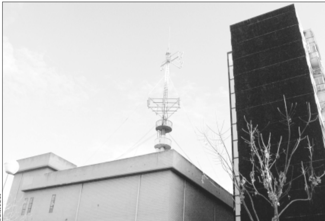
Antena de telefonía móvil instalada en el edificio de la Telefónica de Bellvitge
