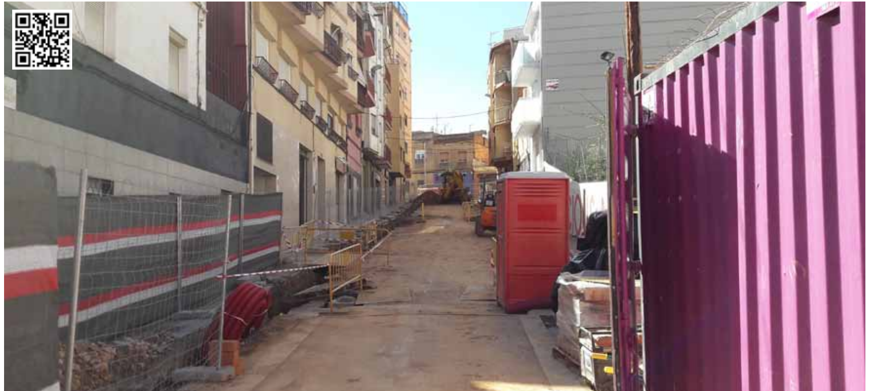
Aspecto de las obras que se están ejecutando en la calle Naranjos
