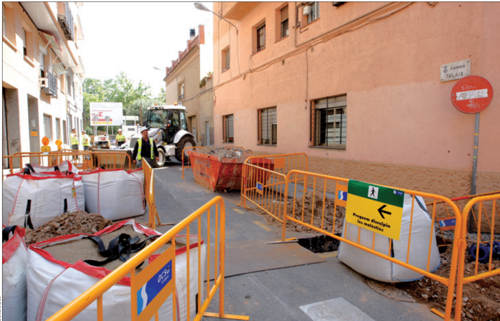
Inicio de obras en la calle de la Talaia financiadas con fondos estatales
