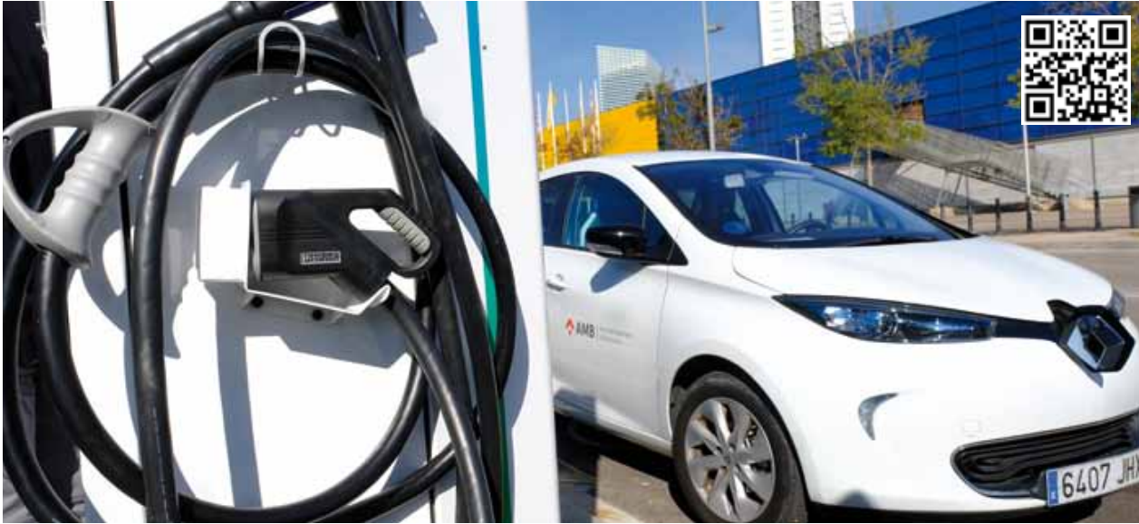
Punt de recàrrega ràpida instal·lat per l'AMB al carrer de Salvador Espriu, darrere l'establiment Ikea
